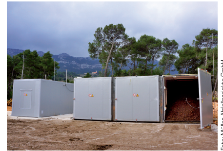
„Mobigas“-Container Biogasanlage für organische Abfälle
